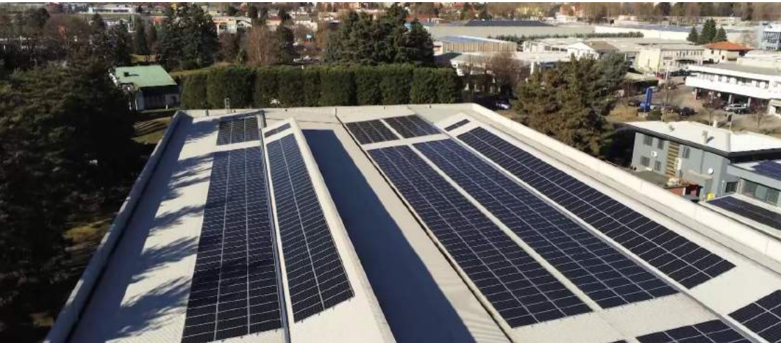
Impianto fotovoltaico stabilimento di Saronno. Potenza: 400 kWh
