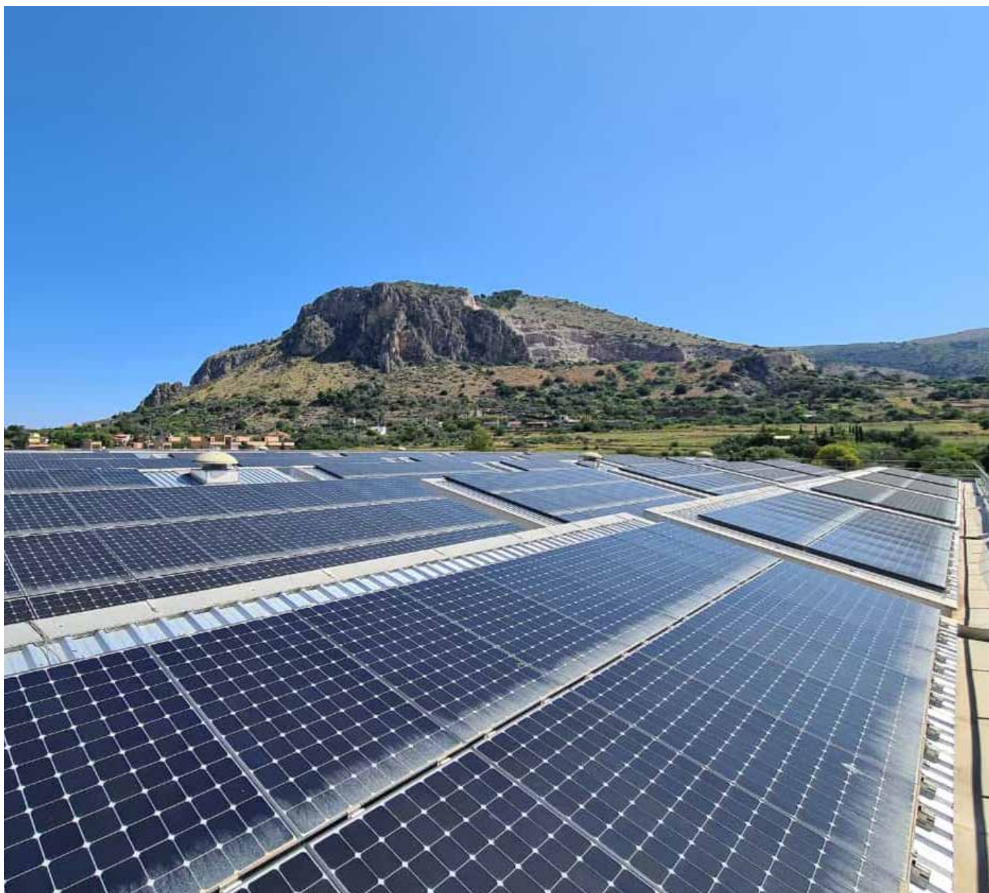
Impianto fotovoltaico di Aspra Potenza dell'impianto: 336 kW Dimensione dell'impianto: 1100 pannelli
